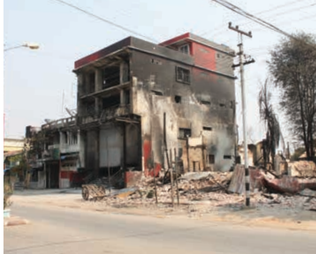
၂၀၁၃ ခုနှစ်၊ မတ်လ ၂၀ မှ ၂၄ ရက်နေ့အထိ ဖြစ်ပွားခဲ့သော မိတ္ထီလာ အရေးအခင်းတွင် ပျက်စီးသွားသည့် အဆောက်အအုံ မှတ်တမ်း။ ဓါတ်ပုံ - ဟိန်းအောင်
