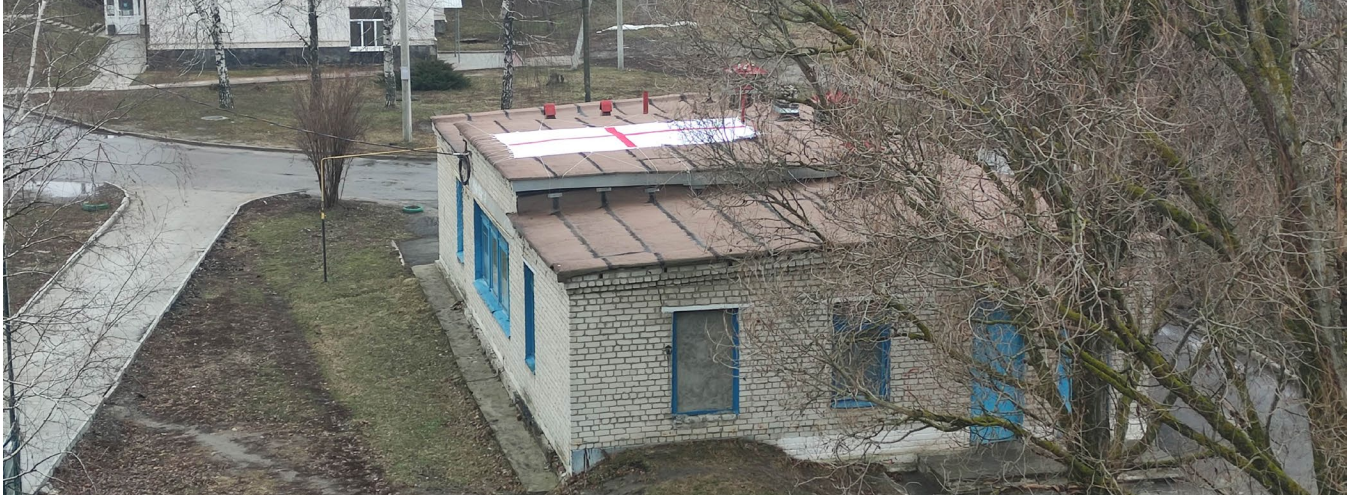
Технічна будівля Ізюмської центральної міської лікарні, яка була пошкоджена внаслідок щонайменше трьох атак у березні 2022 року. На її даху є зображення Червоного Хреста, щоб позначити її статус закладу охорони здоров'я. Фото зроблено лікарем Богданом Бережним у лютому / березні 2022 року.
