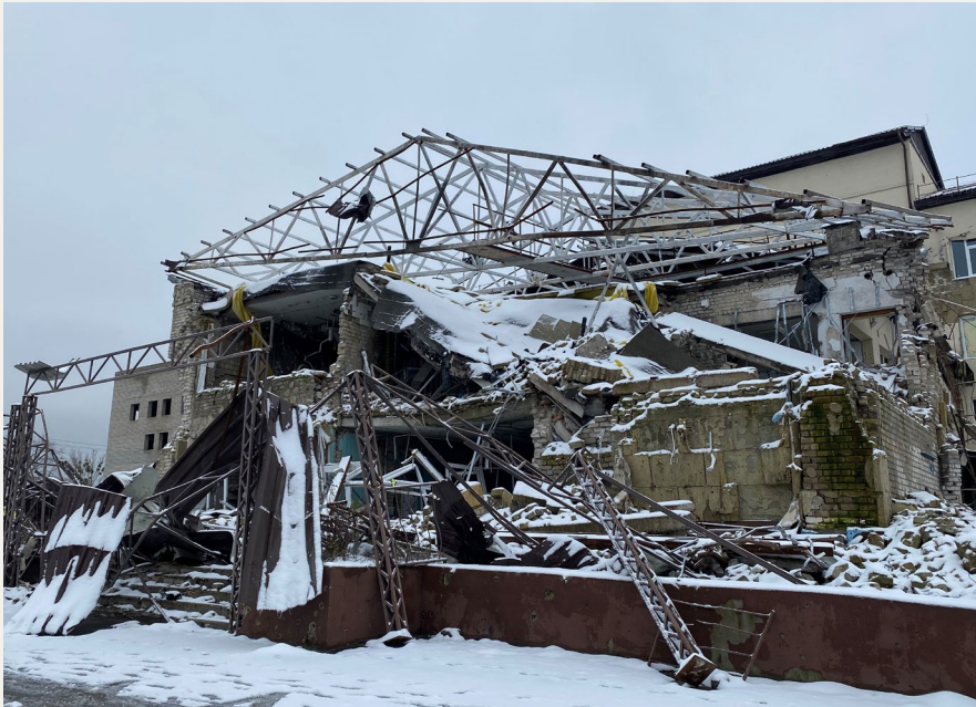
Вгорі: Ізюмська центральна міська лікарня, що була пошкоджена внаслідок щонайменше трьох атак у березні 2022 року. Вигляд ззовні.
