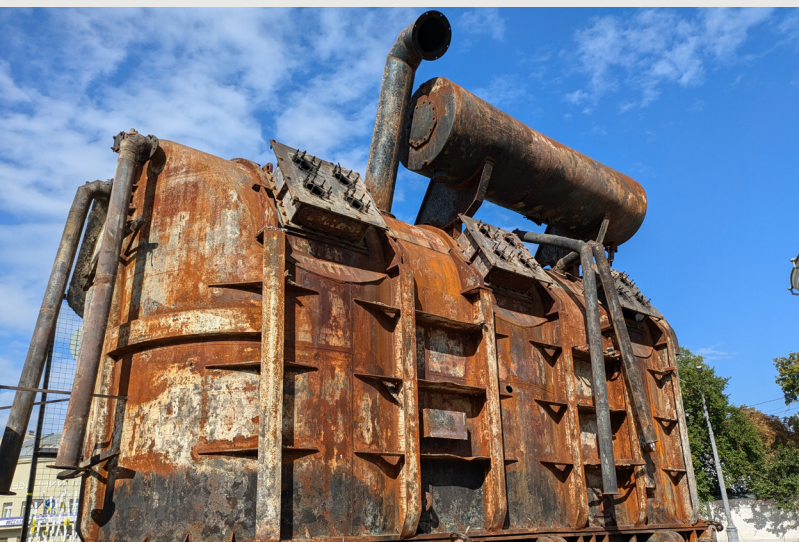
Зруйнований трансформатор з Бурштинської ТЕС виставлений на площі в Києві. В Україні більше не виробляють такі трансформатори, тому їх важко замінити. Фото зроблене Physicians for Human Rights у вересні 2024 року
